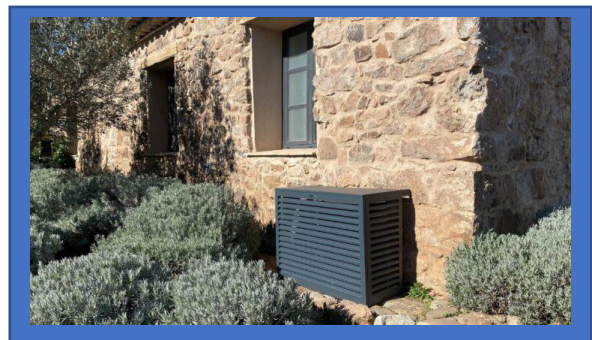
Pompe à chaleur avec cache correctement intégrée devant une façade traditionnelle. Photo DR.
